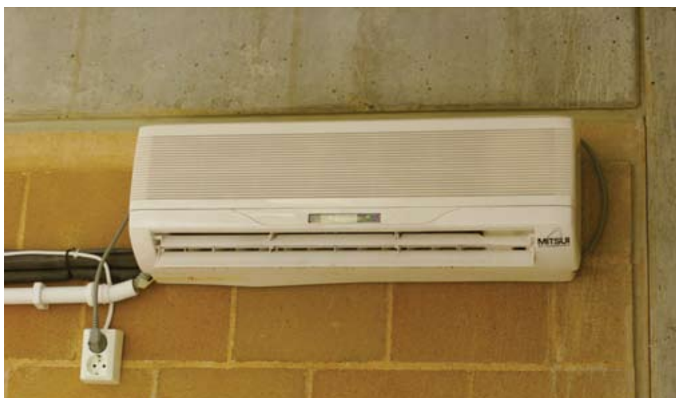
Kjøleanlegg fås som relativt små enheter dersom serverrommet er lite...
